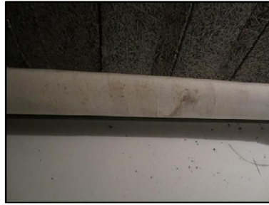
Photo N° 651 ECH-N°3 CALORIFUGEAGE --LOCAL POUBELLE 1 Conduits de fluide Laine minérale + enveloppe plâtrée
