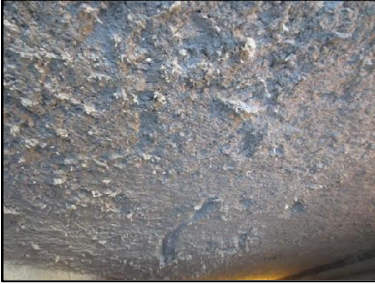
Photo N° 663 ECH-N°1 FLOCAGE -- LOCAL CHAUFFERIE Plafonds Blanc Cotonneux
